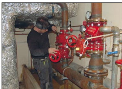
Rickard server en sprinklercentral.
